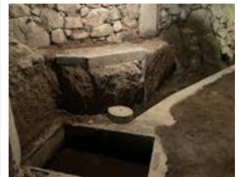
Quellfassung im Keller
