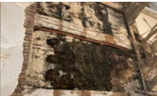
Freigelegte Kuchendecke, geschwärzt vom Rauch
